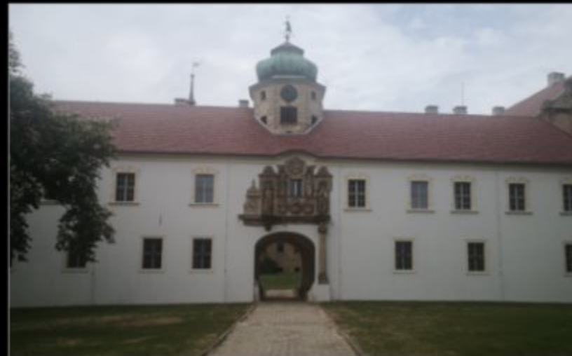
Vorne hui, hinten pfui. Zerfällt zusehens
